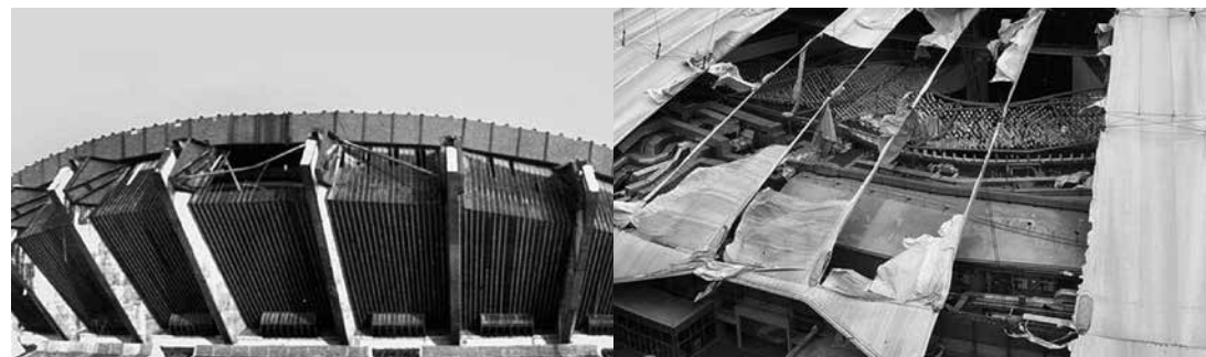
Due strutture collassate: F.2 Palazzo dello sport S. Siro Milano e F.3 Millennium Londra / Two collapsed structures: F2. Palace of Sport S. Siro Milano and F3. Millennium London.
